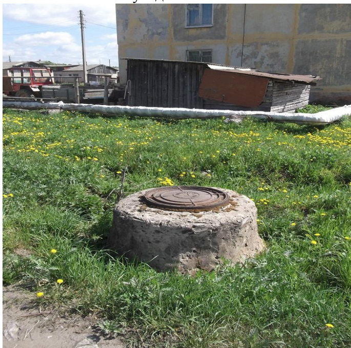
Фото 9.1.19 Колодец канализации в с. Фоминское
