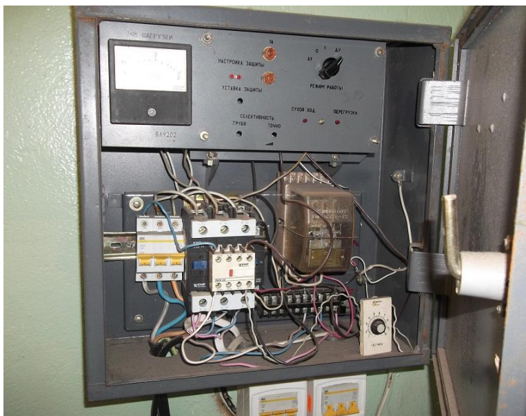
Фото 3.16.7 Щит управления на станции «Струя-200» пос. Мисково
