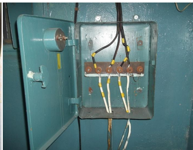
Фото 3.16.8 Распределительный щит на станции СТРУЯ-200 пос. Мисково
