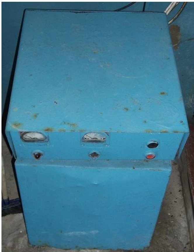
Фото 3.16.9 Блок управления на станции водоочистки СТРУЯ-200
