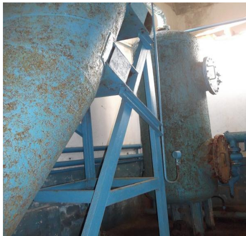
Фото 1.4.6 Фильтровальное оборудование станции «Струя-200» в пос. Мисково
