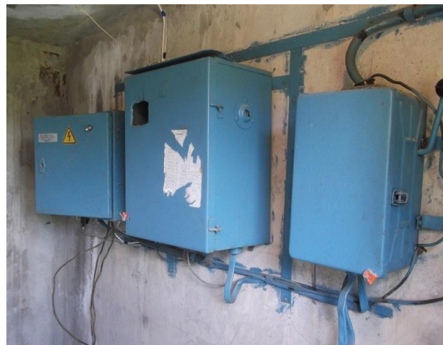
Фото 3.16.2 Шкафы питания и управления скважинным насосом с. Фоминское
