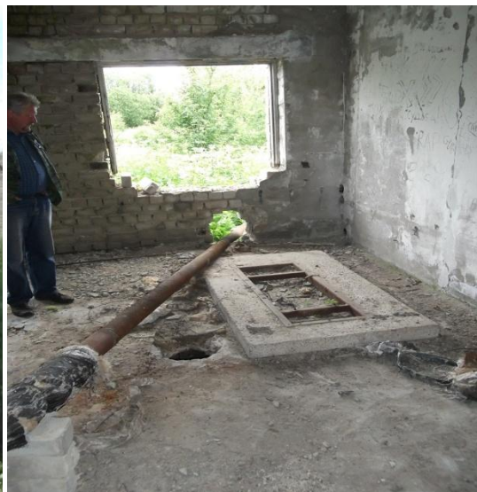
Фото 9.1.12 Сквозной трубопровод и фундаментная плита системы аэрации и перекачки в аэротэнках в с. Сандогора
