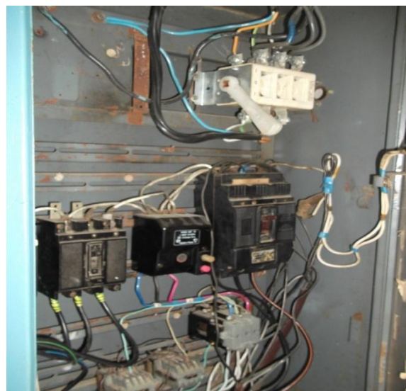
Фото 3.16.4 Щит управления насосом скважины с. Сандогора
