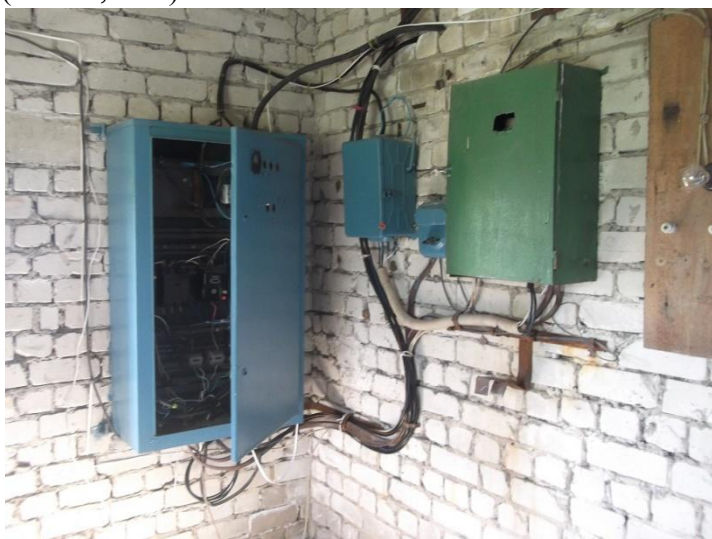
Фото 3.16.3 ВРУ скважинных насосов на РЧВ с. Сандогора
