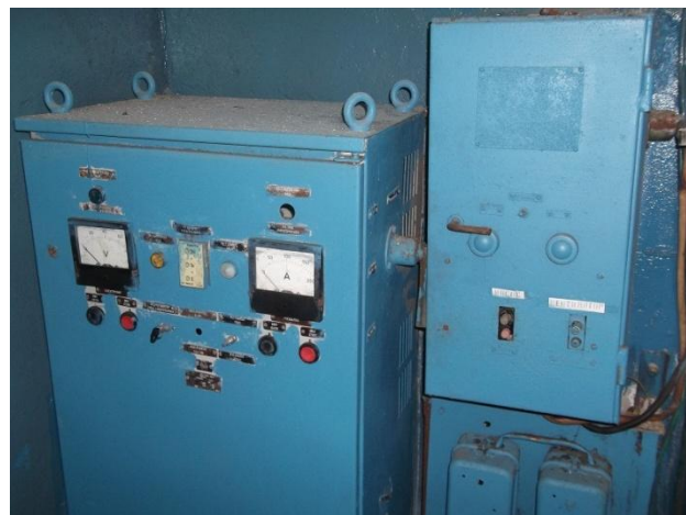
Фото 3.16.12 Блок управления станции СТРУЯ-200 пос. Мисково
