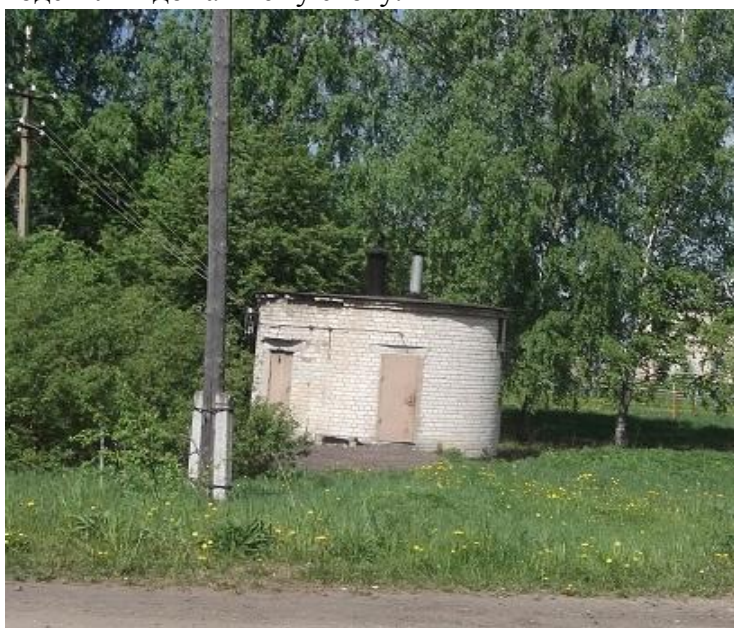
Фото 9.1.9 КНС первого подъёма в с. Сандогора на ул.Дворище
