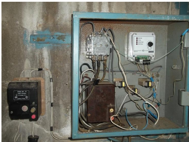
Фото 3.16.1 Вводное распределительное устройство (ВРУ-0,4 кВ) скважин с. Фоминское
