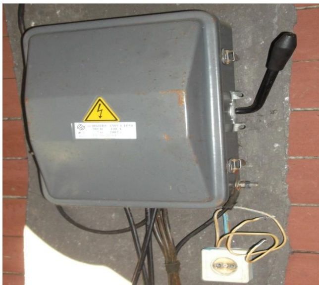
Фото 3.16.11 Вводной рубильник скважины №686 пос. Мисково
