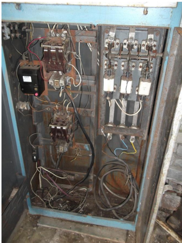
Фото 3.16.5 Шкаф ВРУ КНС пос. Мисково
