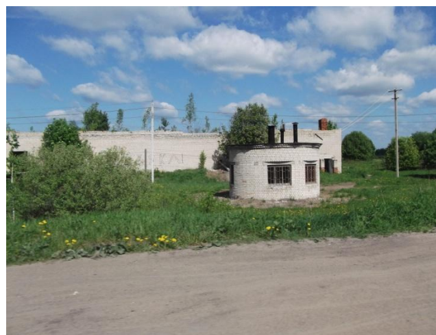
Фото 9.1.10 КНС второго подъёма в с. Сандогора на ул.Дворище
