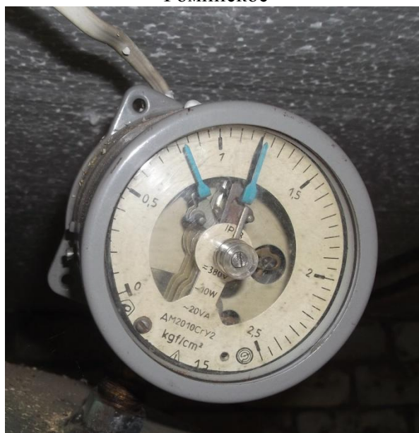
Фото 1.4.24 Электроконтактный манометр гидроаккумулятора скважины №4406 с. Фоминское
