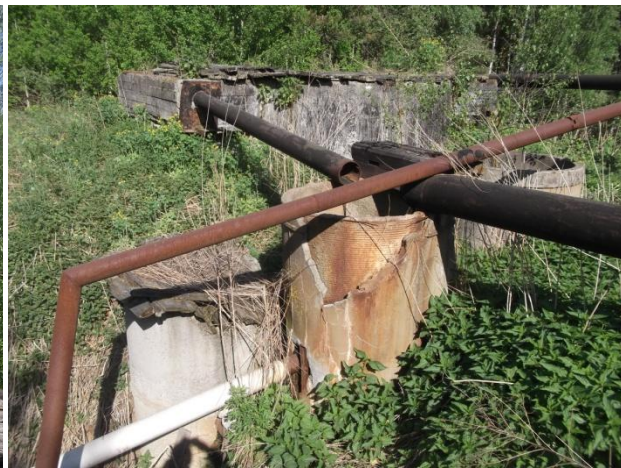
Фото 9.1.4 Канализационные трубопроводы на коллекторе очистных сооружений пос. Мисково
